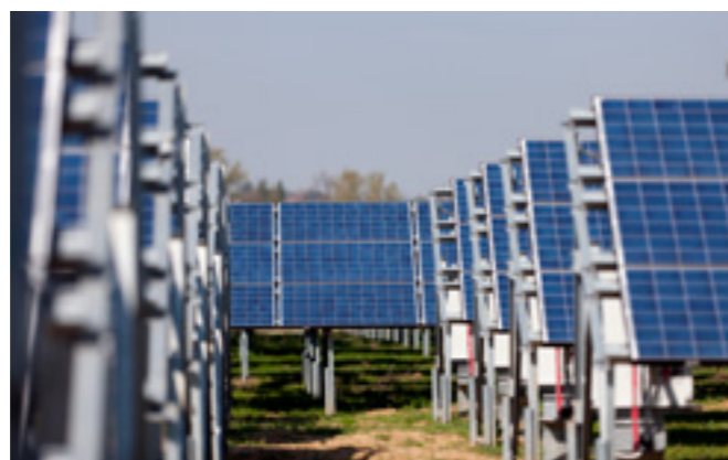
Parco fotovoltaico di Valenza
