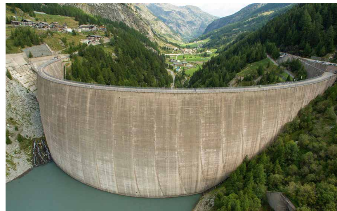
Diga di Beauregard estate 2010
