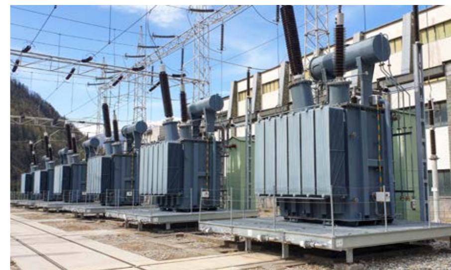
Centrale di Valpelline: monitoraggio DGA online dei 6 trasformatori monofase
